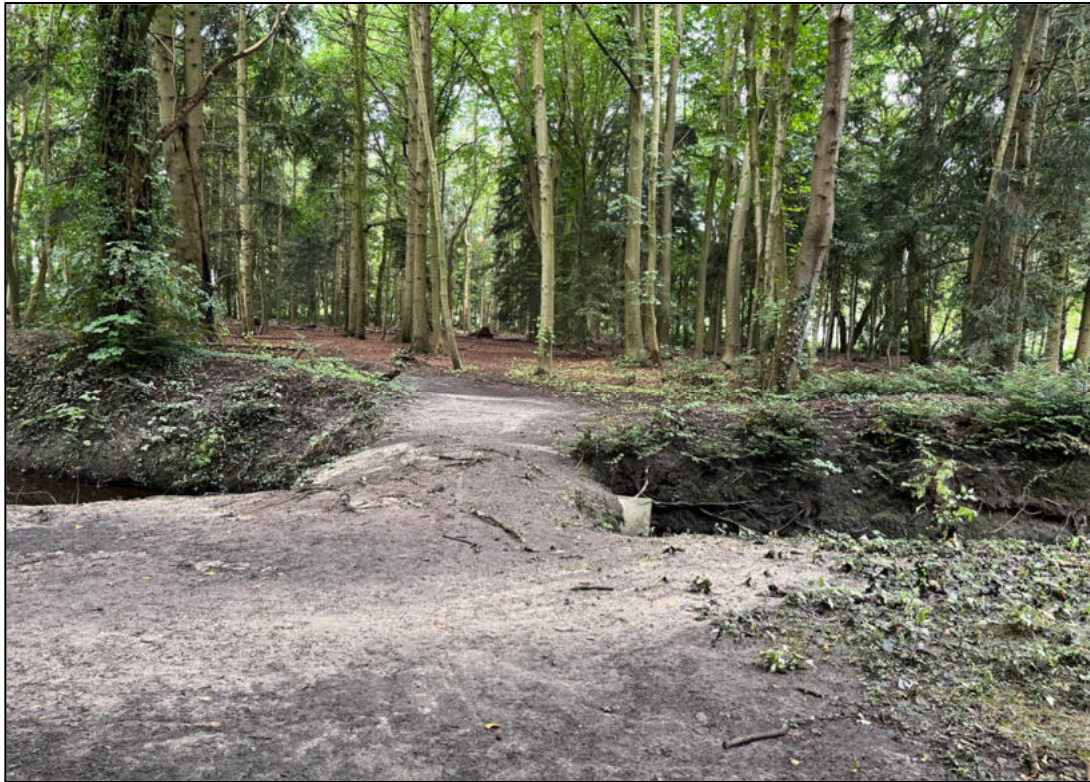
Abbildung 14: Querung (Durchlass) Molkereischloot im Westen
