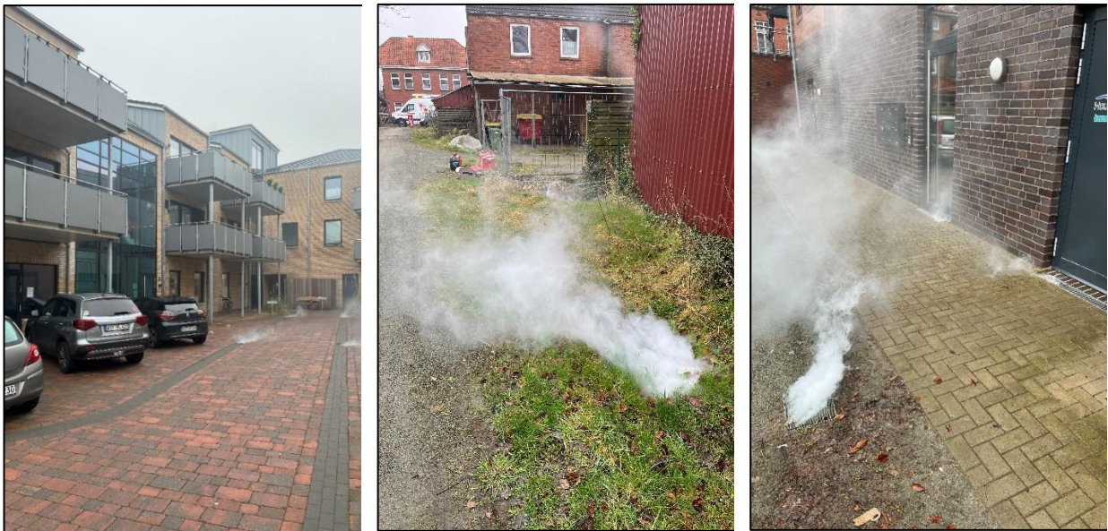
Abbildung 3: Prüfung Anschlussrichtung durch Nebelung der nördlichen Nebenanlagen (links); südliche Nebenanlage, verdeckter Straßenablauf (Mitte); Prüfung Anschlussrichtung der südlichen Nebenanlagen (rechts)
