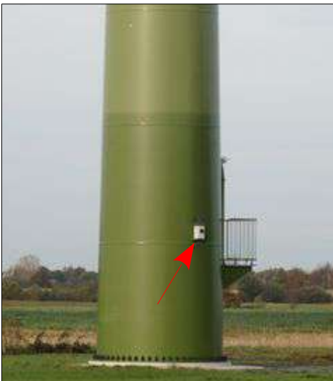
Abbildung 3: Batcorder in der Waldbox-erweiterung am Mastfuß installiert
