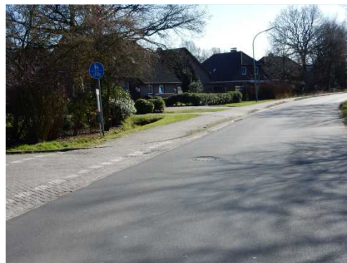
Hebungen und Senkungen im Bereich von Einfahrten (Schoolpad)
